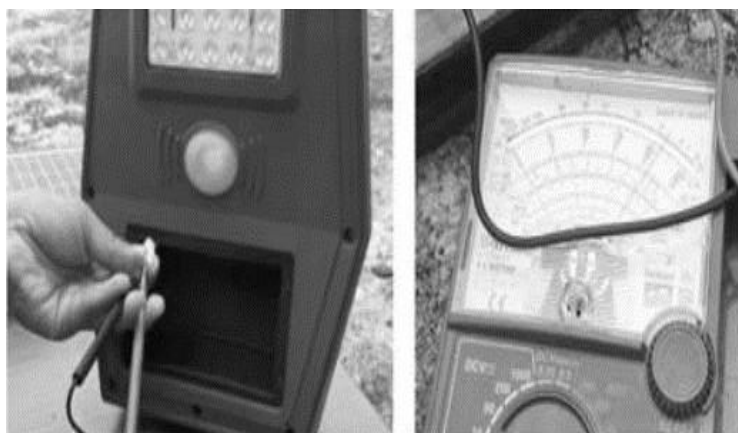
Gambar 6. Pengukuran Tegangan keluaran dr solar cell
